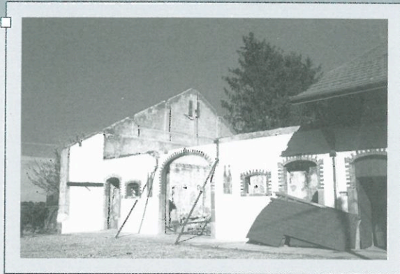
Vue du chantier de la première phase des travaux : les murs principaux sont conservés mais la toiture est déposée.
