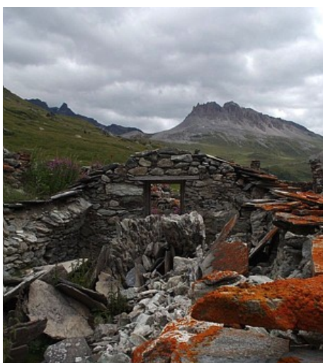
Figure 15 : Ruine due au toit abîmé, dans la commune de Termignon (nouvellement Val-Cenis).
