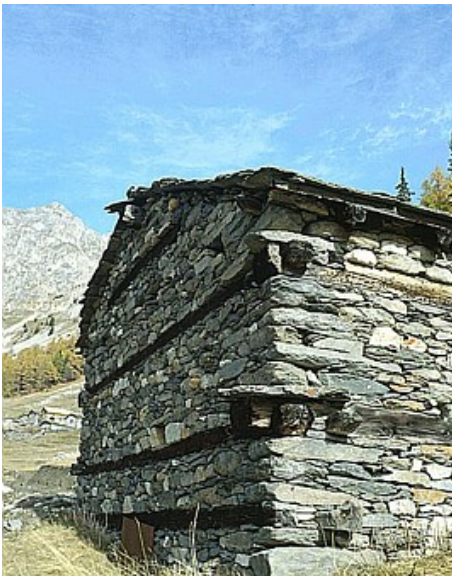
Figure 12 : Mur en maçonnerie de blocage avec chaînage en bois, chalet d'alpage au lieu-dit de Polset (Modane).
