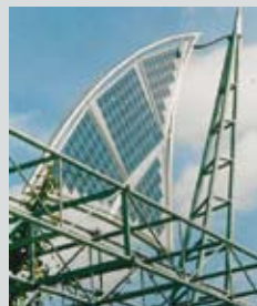
Capitainerie, voile solaire photovoltaïque Charpignat
