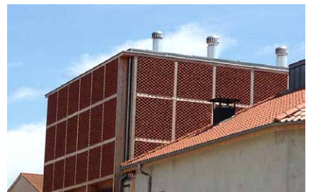
Le Briscope à Brignais : Ventilation naturelle par tourelles à vent
