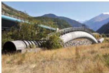
LA PRAZ (LE FRENEY) Conduite forcée de l'ancienne usine d'aluminium
